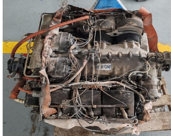
Figura No.5 Condición del Motor #2
