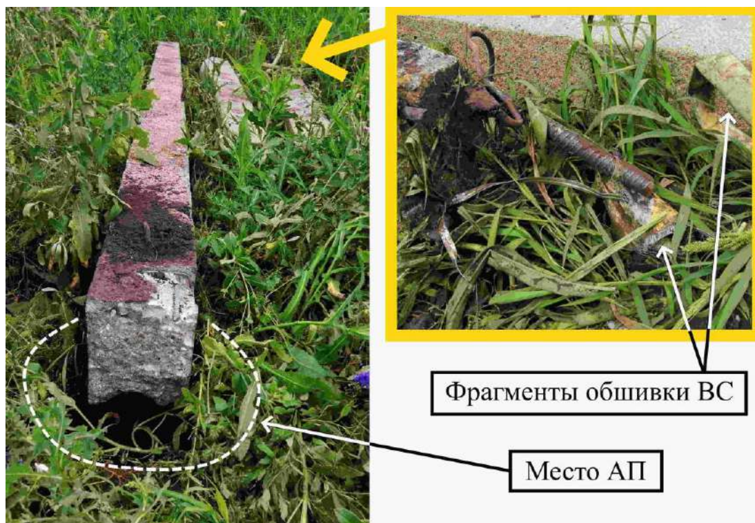
Рис. 4. Разрушенная опора ЛЭП на месте АП
