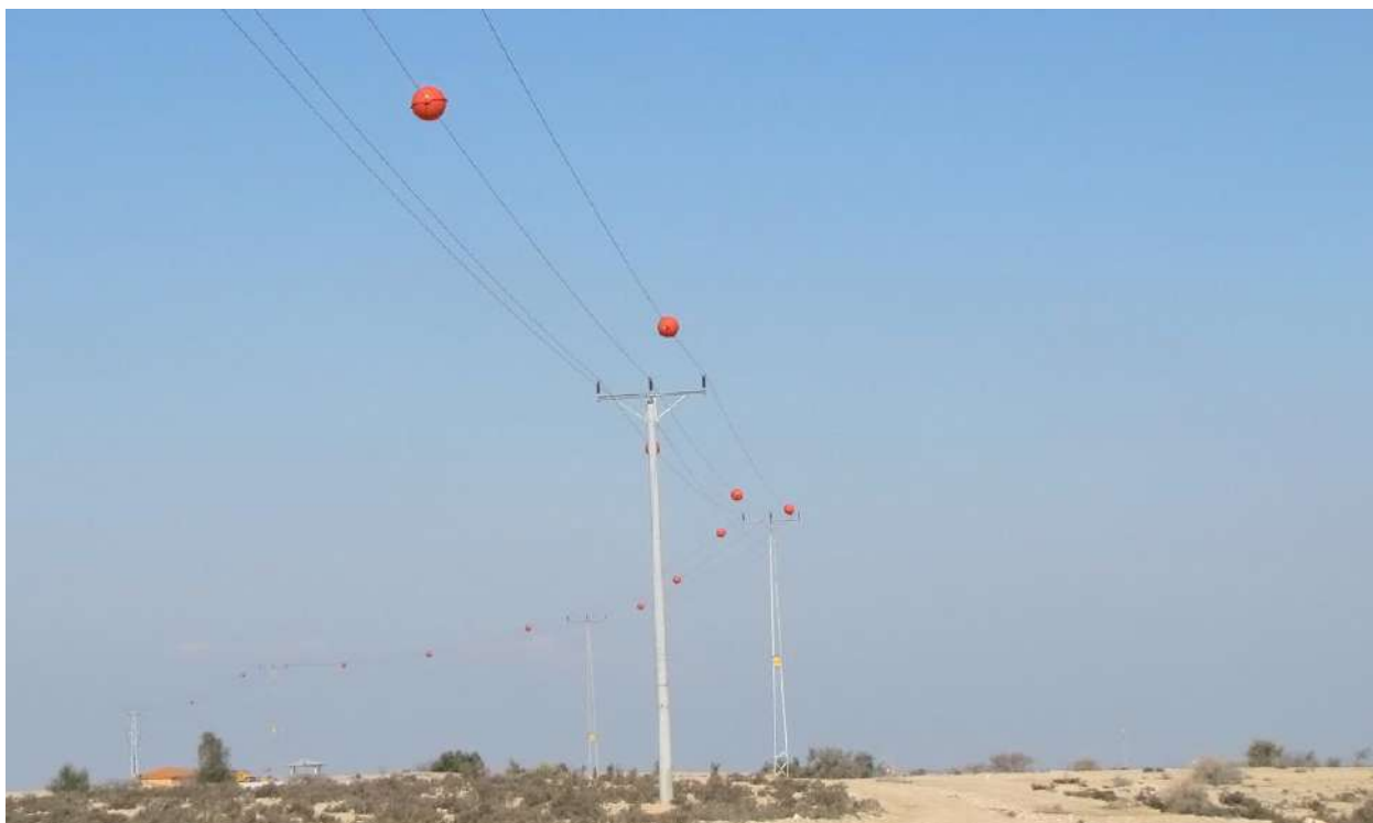
Рис. 10. Воздушная ЛЭП с сигнальными шарами-маркерами для дневной маркировки
