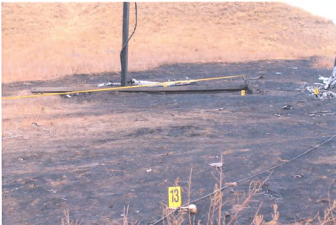
Рис. 8. Поврежденный столб и подкос столба опоры ЛЭП.
