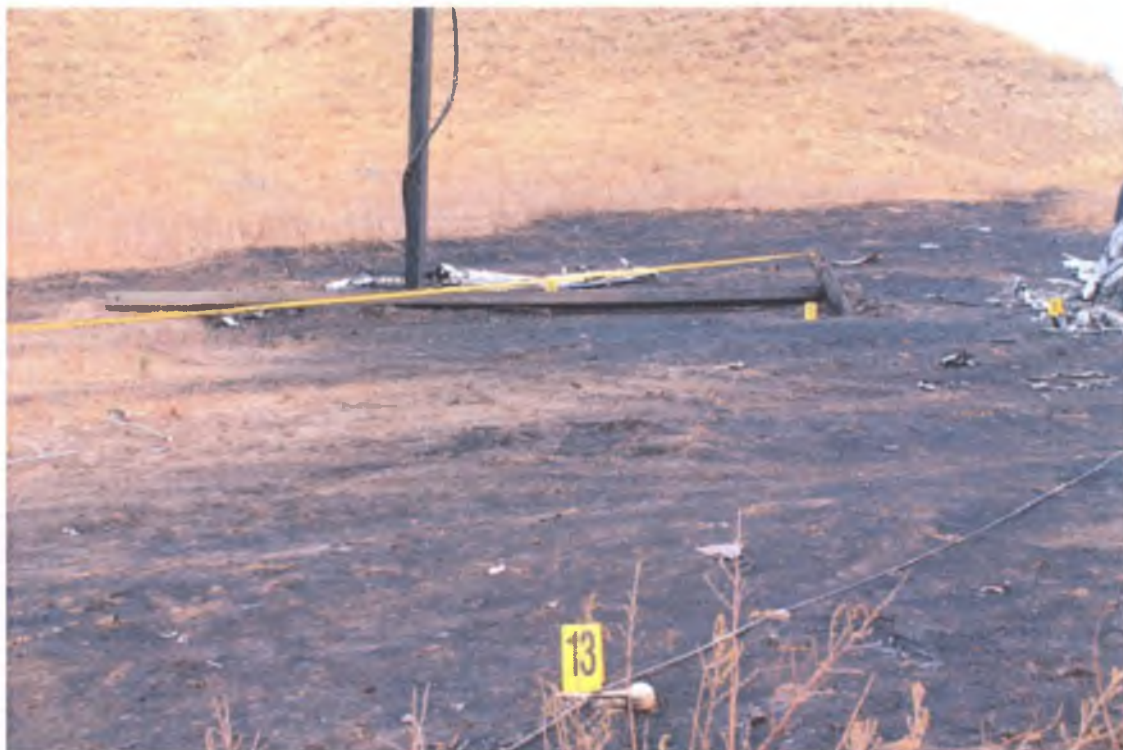
Рис. 8. Поврежденный столб и подкос столба опоры ЛЭП.
