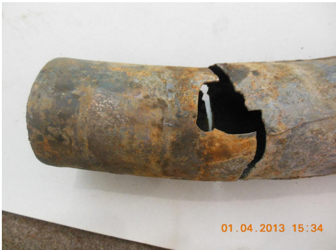
Рис. 6 Состояние левой жаровой трубы выхлопного коллектора
