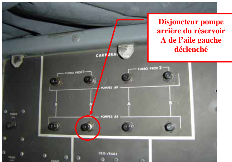
Position des disjoncteurs des huit pompes carburant
