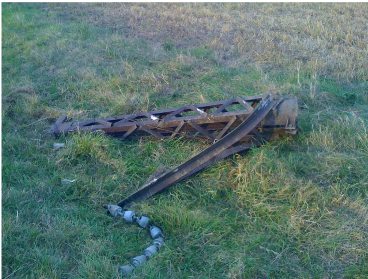
Рис. № 3. Поврежденная троссостойка с грозозащитным проводом бетонной опоры ЛЭП № 44.
